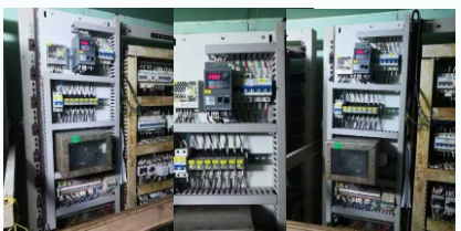
物料小车控制系统现场应用
