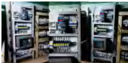
物料小车控制系统现场应用
